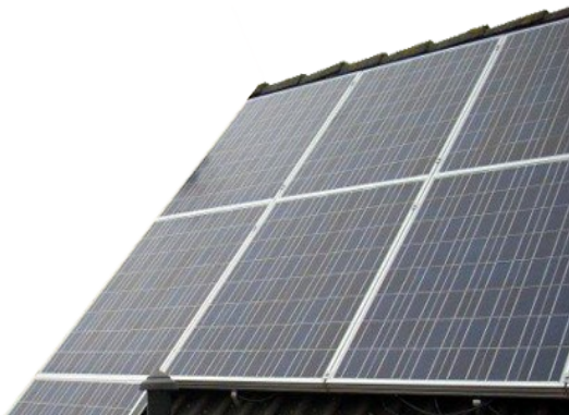
voorbeeld van zonnepanelen op een schuin dak
